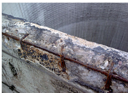
Bild 1. Schaden an der Krone
